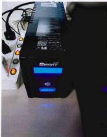
21.เครื่องสำรองไฟฟ้า ขนาด 1 KVA
